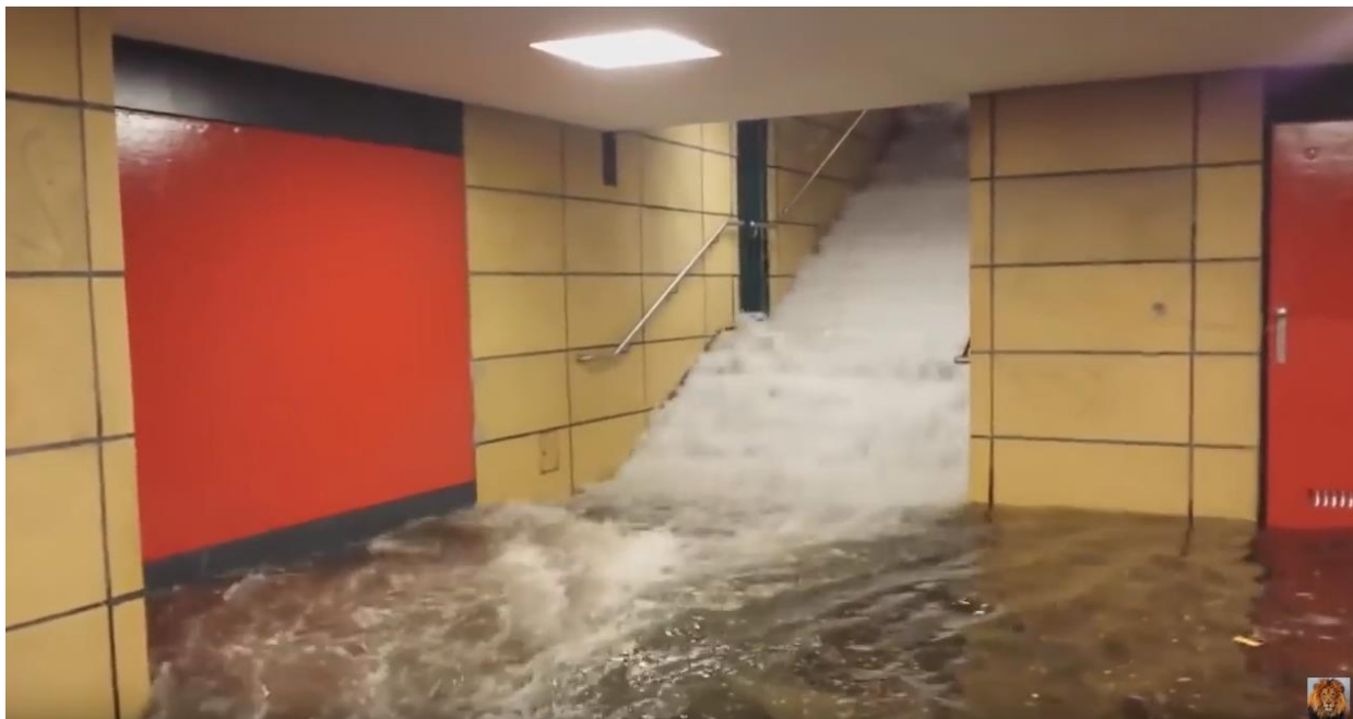
Abb.3.3.2: Überflutung U-Bahn-Haltestelle Walter-Schreiber-Platz./ Berlin / Unwetter 27.4.2016
